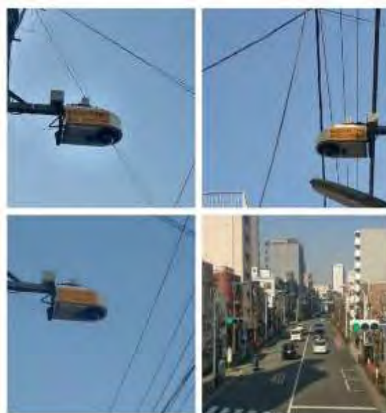
町内稼働中の防犯カメラ（一部）
