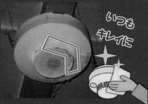
ほこりの溜まった住宅用火災警報器
