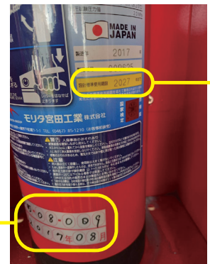
① 消火器設置年月
